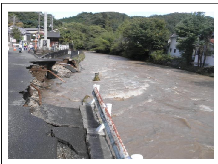
平成29年台風21号南浅川護岸崩落（西浅川町）
